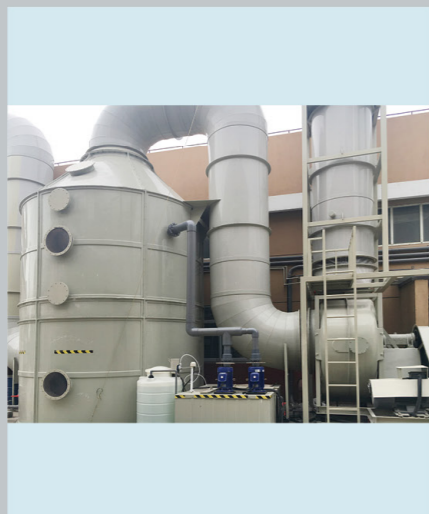
廢氣設備 Exhausts
